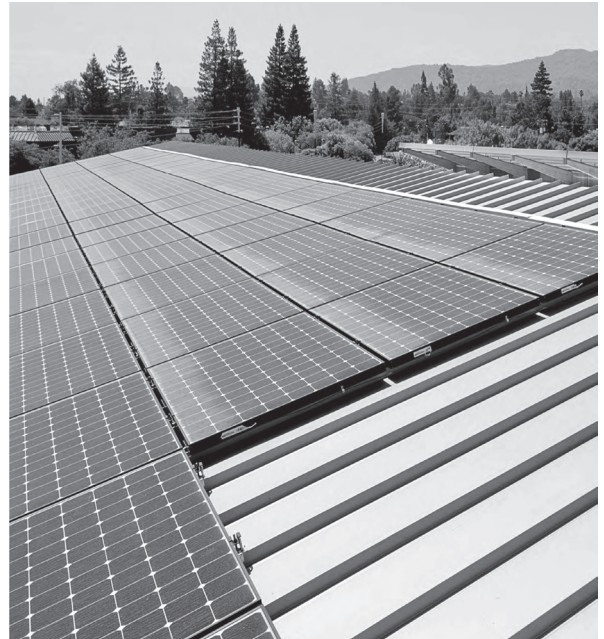
شکل شماره ۱۳- پانل‌های فتوولتائیک بر روی بام ساختمان پاکارد
