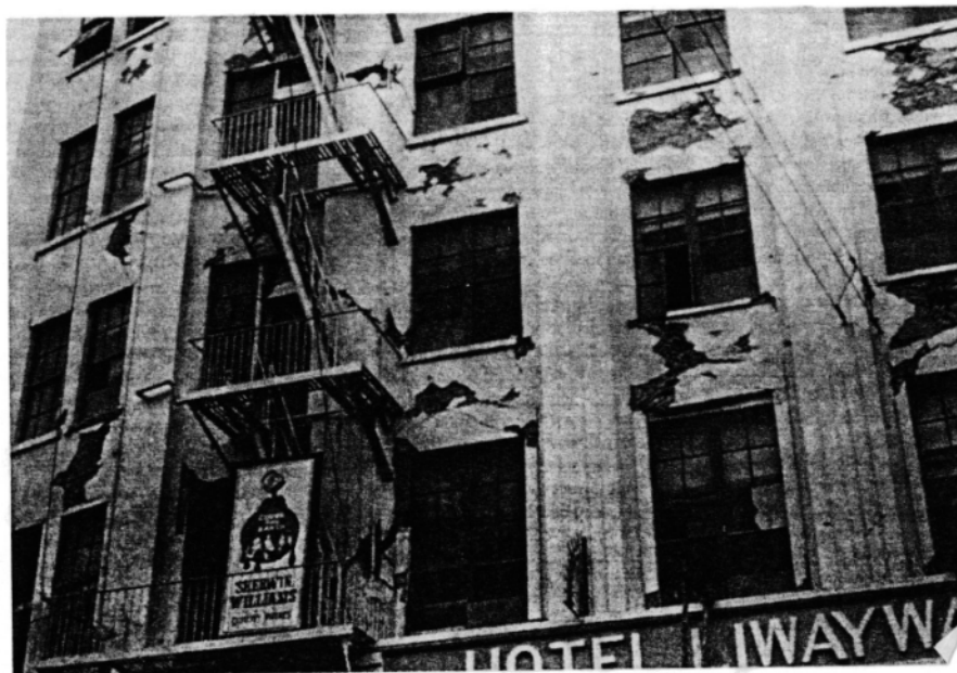
شکل ۷- هتل LIWAYWAY در مانیل فیلیپین. ستونهای عریض و تیرهای پیرامونی مرتفع، این سازه را قادر می سازد که حتی با وجود ترك خوردگی، استحکام خود را حفظ کند. این عکس پس از زلزله ۷ ریشتری آگوست سال ۱۹۶۸ برداشته شده است.
